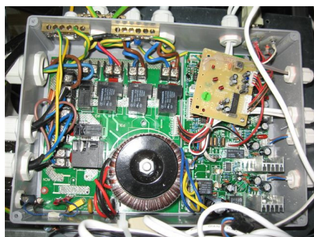
Câblage du boîtier principal
